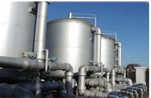
霞ヶ浦浄水場 (かすみがうら市西成井地内)
