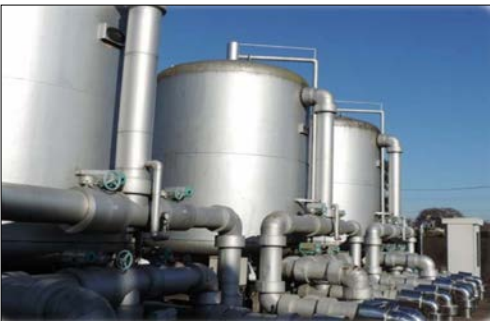
霞ヶ浦浄水場（かすみがうら市西成井地内）
