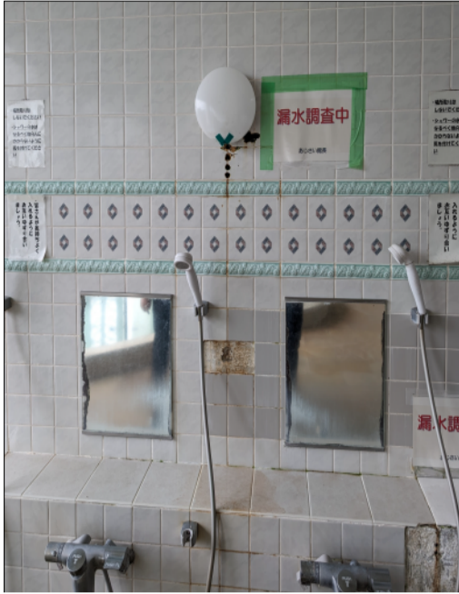
壁面から漏水調査中とあり、配管及び壁面の劣化状況や躯体への影響の有無等を確認している＝あじさい館内の浴室2024年6月撮影
